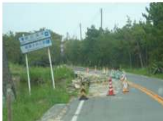
▲崩れた道路・曲がった標識
